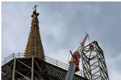
Après quatre ans de chantier, la rénovation de la flèche Saint-Michel s'achève en mai. © Ville de Bordeaux
